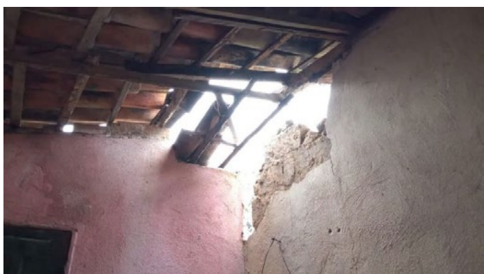
Figura 4 – Casa da cidade de Amargosa na Bahia, após terremoto
