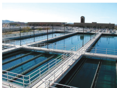
Figura 2. Visualização parcial de uma estação de tratamento de água. Disponível em: < http://portaldoprofessor.mec.gov.br/fichaTecnicaAula.html?aula=893 > Acesso em: 11 dez. 2012
